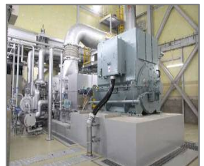
●蒸気タービン発電機
