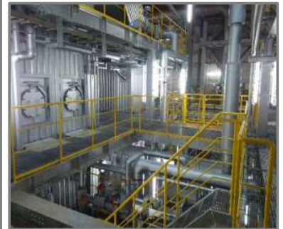
●ガス化溶融炉（炉室）
